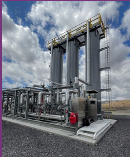
An LNG prepurifier system
